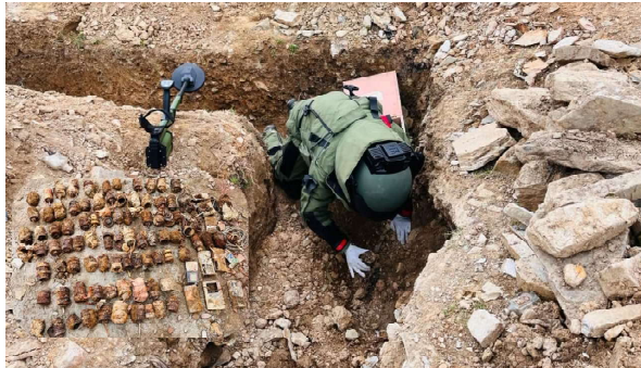
काठमाडौं। सन्धानको जिल्ला प्रहरी कार्यालय भवन निर्माणका लागि जरा खन्ने क्रममा ठूलो मात्रामा विस्फोटक पदार्थ फेला परेको छ। जिल्ला प्रहरी कार्यालय सन्धान का प्रमुख प्रहरी नायब उपरीक्षक हेमबहादुर केसी का अनुसार ८६ वटा सक्रेट बम, ३ वटा सुतली बम र १ वटा बोटल बम गरी ८६ थान
